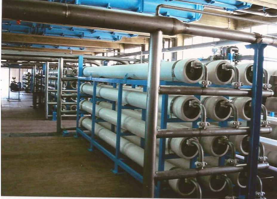
Figura 8: Máquina de Dessalinização da água do mar por Osmose Inversa de Porto Santo, Madeira
